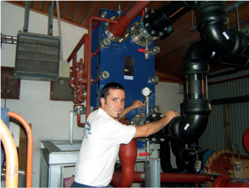
Bademeister Maik Wittgrebe überzeugt sich vom effizienten Einsatz des modernen Wärmetauschers.
